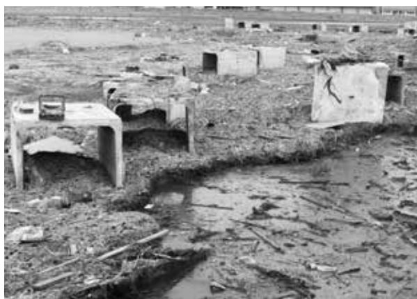
図1. 液状化と津波による複合作用によって生じた埋設物の浮き上がり
