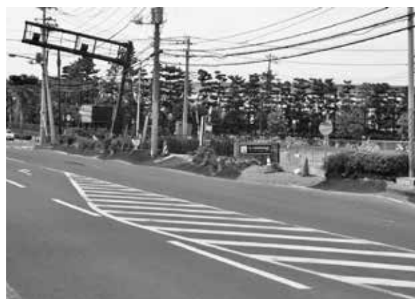
図4. 浦安の波打つ道路, 隆起する歩道 (下水管が埋設されている), 傾く交通構造物
