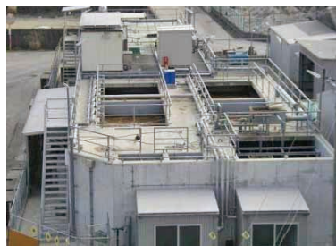
水処理プラント
