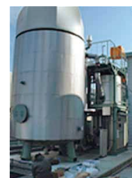
メタン発酵プラント
