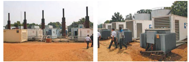
写真7. ジュバの発電設備
